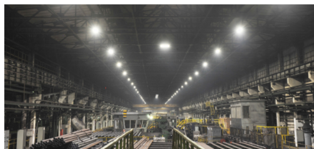
Новые светодиодные светильники в трубопрокатном цехе
